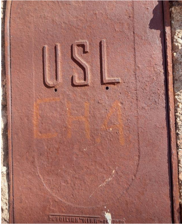
Usina de San Luis. 1902
